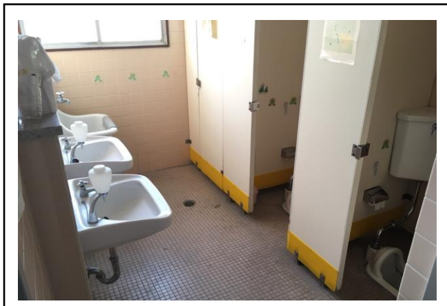
●女子トイレ（内部1） 洗面台2台、スロップシンク1台
