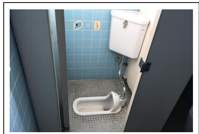
●男子トイレ（内部2） 大便器（和式）1台
