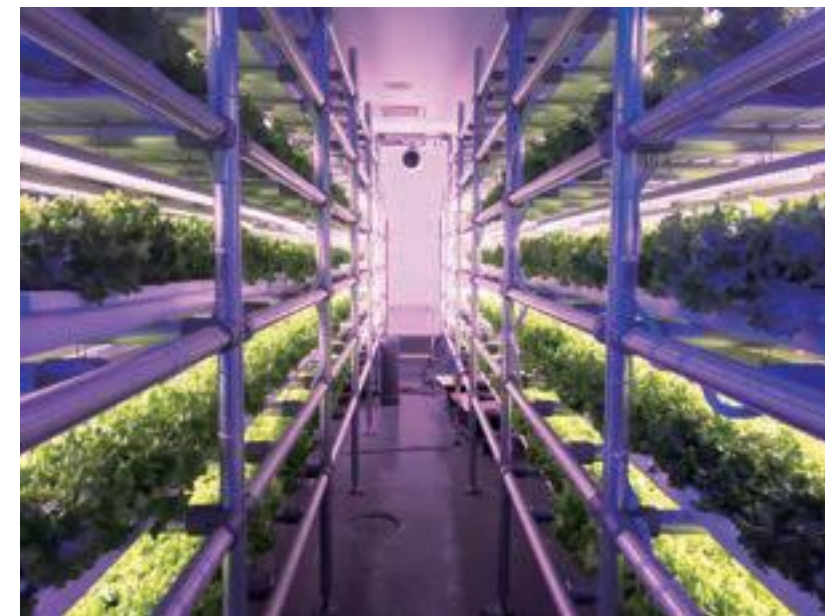
京都府立大学産学公連携研究拠点 施設内植物工場施設
