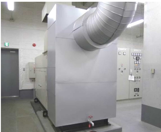
写真 4-20 自家発電機室の発電機設備
