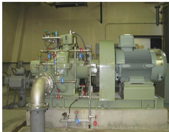
写真 4-15 送水ポンプ設備・桜が丘配水池へ
