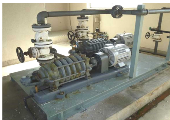
写真 4-33 旭第1 浄水場 送水ポンプ
