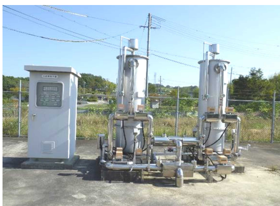
写真 4-32 旭第1 浄水場 ろ過機
