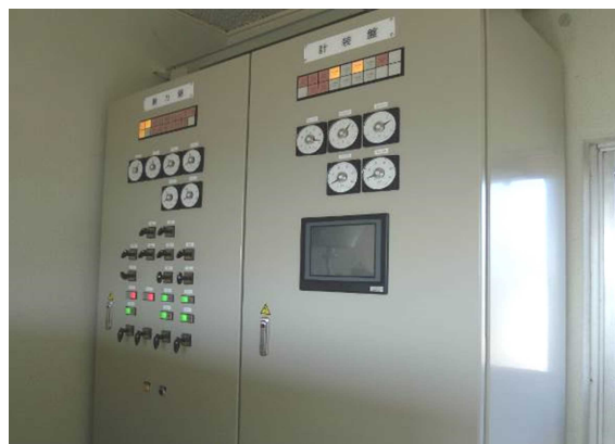
写真 4-35 旭第1 浄水場 送水ポンプ操作盤
