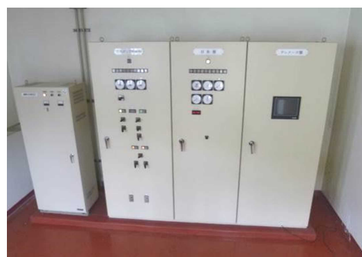
写真 4-27 東畑第 1 加圧ポンプ場制御盤
