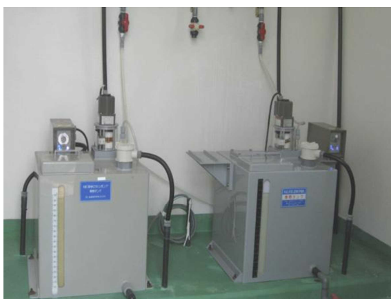
写真 4-12 薬液注入ポンプ室
