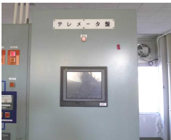
写真 4-6 テレメータ盤
