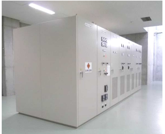
写真 4-21 電気室（動力盤など）
