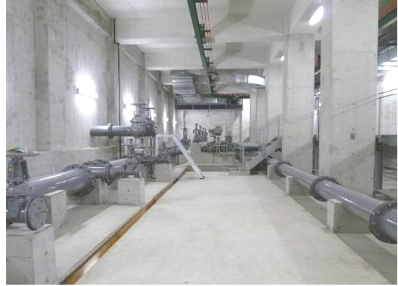
写真 4-19 送水ポンプ室
