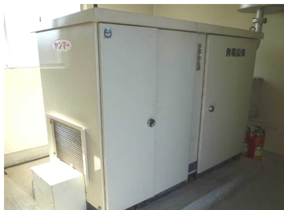
写真 4-31 旭第1 浄水場 発電機設備
