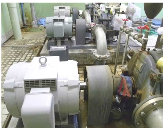
写真 4-4 送配水ポンプ
