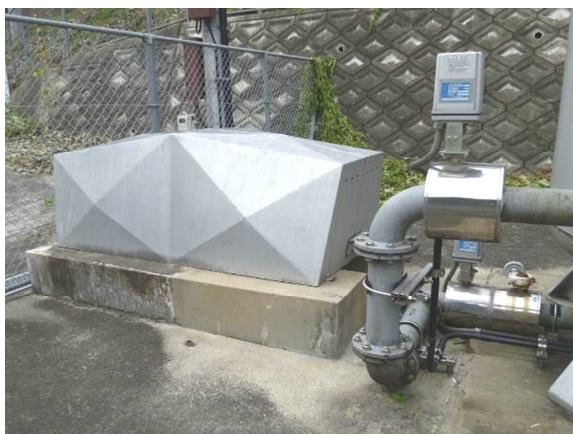
写真 4-10 取水井 第1号取水ポンプ
