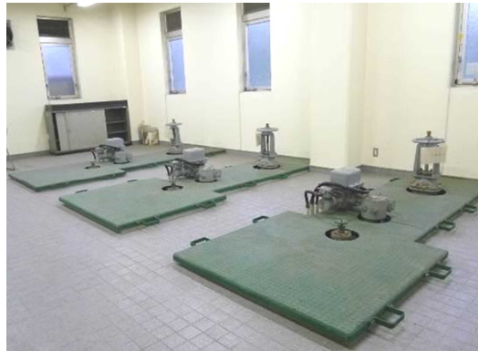
写真 4-29 光台中継加圧ポンプ場 送水ポンプ
