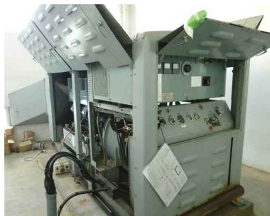
写真 4-7 発電機室内の発電機設備
