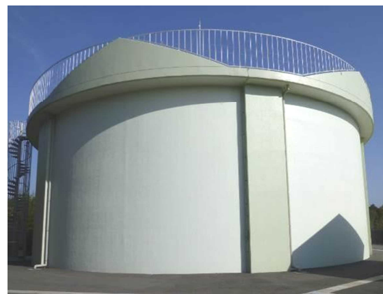
写真 4-25 北稲配水池(容量:3,800m 3 )
