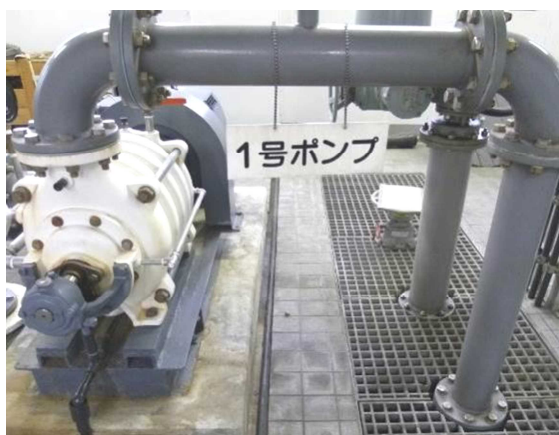
写真 4-13 送水ポンプ室 1号送水ポンプ
