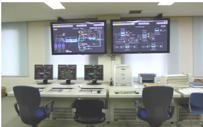
写真 6-3 上下水道部事務所 2 階にあるグラフィックパネル（遠方監視盤）
