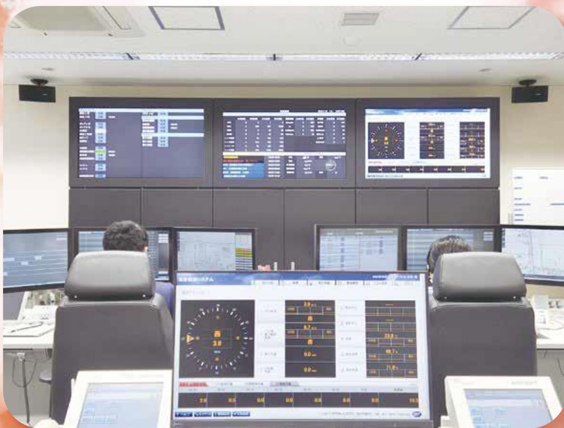
【高機能消防指令センター】
