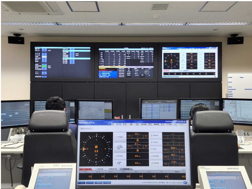
【高機能消防指令センター】
