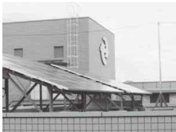
庁舎屋上の太陽光パネル
