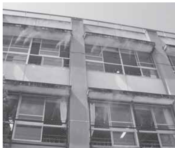
霧を吹き出しているドライミスト
