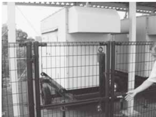
小学校の発電システム
