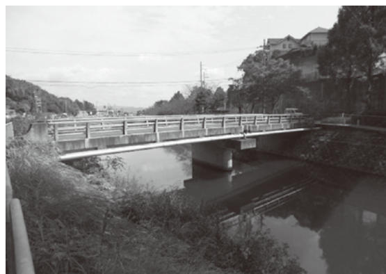
老朽化した橋梁
