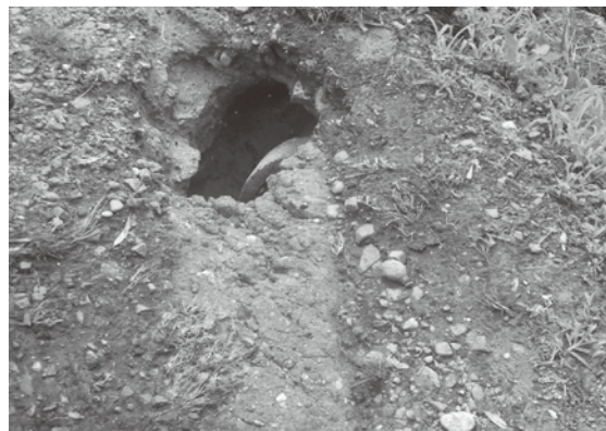
むき出しになった土管
